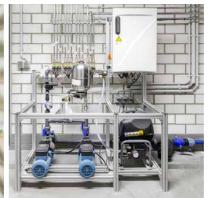
Technikraum für das vollautomatische Versorgungssystem. Bildquelle: Stefan Schilling
